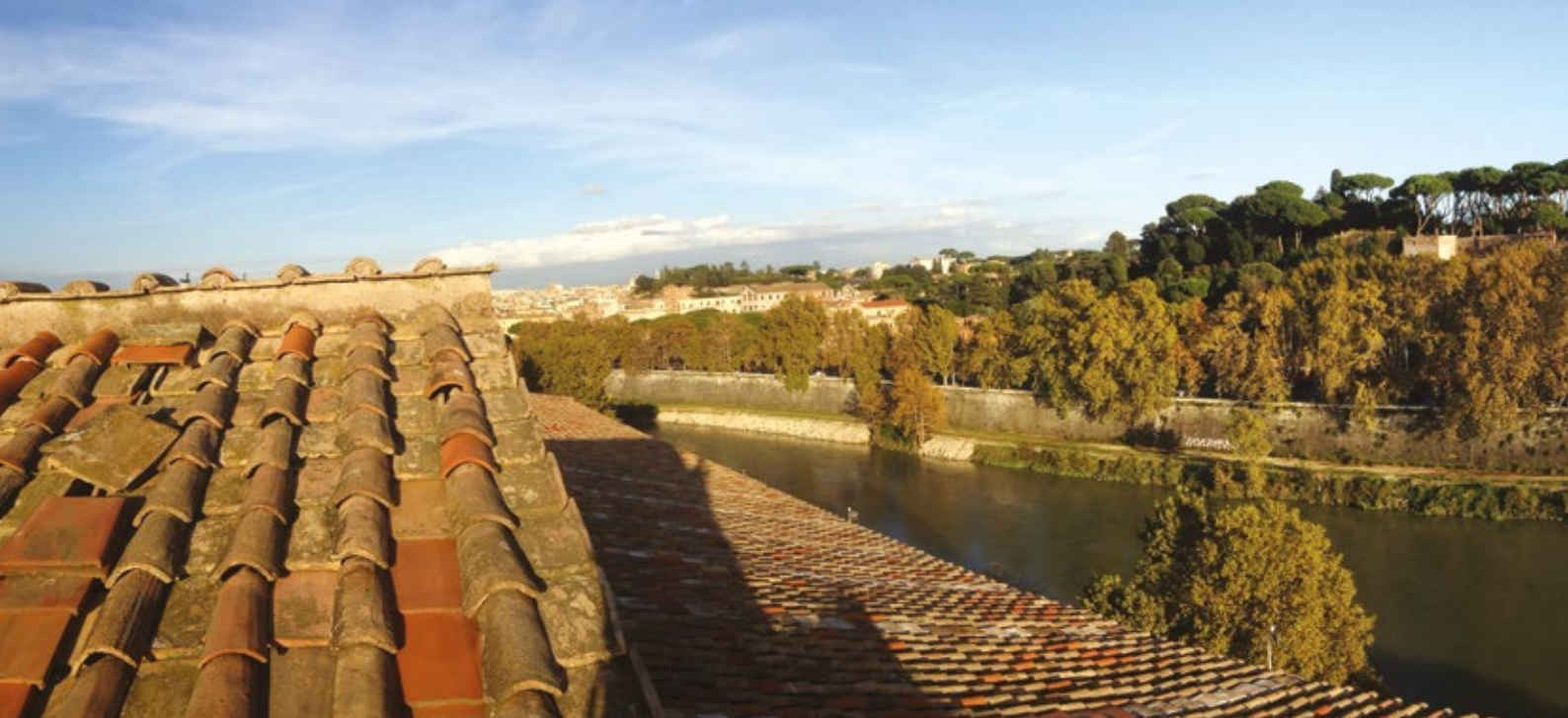
REVISIONE TETTO E GRONDAIE - MINISTERO DEI BENI CULTURALI ISTITUTO SAN MICHELE - ROMA
